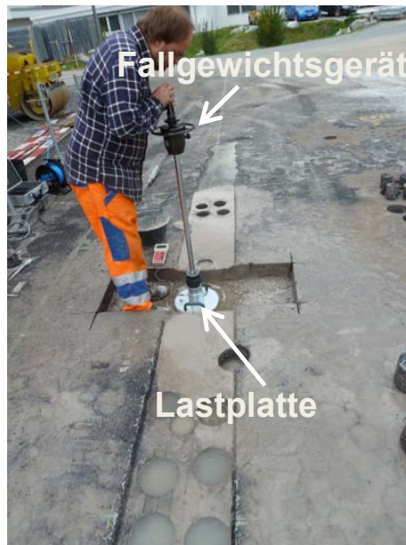
Abb. 17 LFG Messungen nach dem Test
