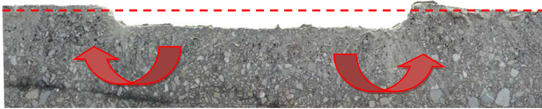
Abb. 35 Verschiebung des Belagsmaterials auf beide Seiten der Fahrspur
