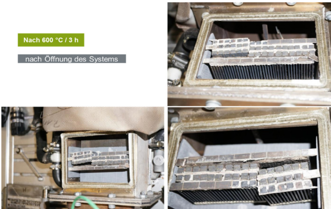
Abbildung 139: Schadensbild nach Versuch bei Lufttemperatur von 600 °C: komplette Ablösung vom Kaltseiten-Wärmeübertrager
