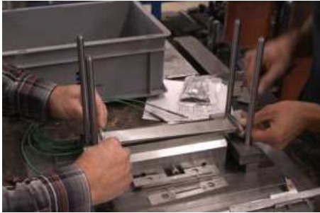
Abbildung 2-44 Der erste Wärmeübertrager wurde eingefügt
