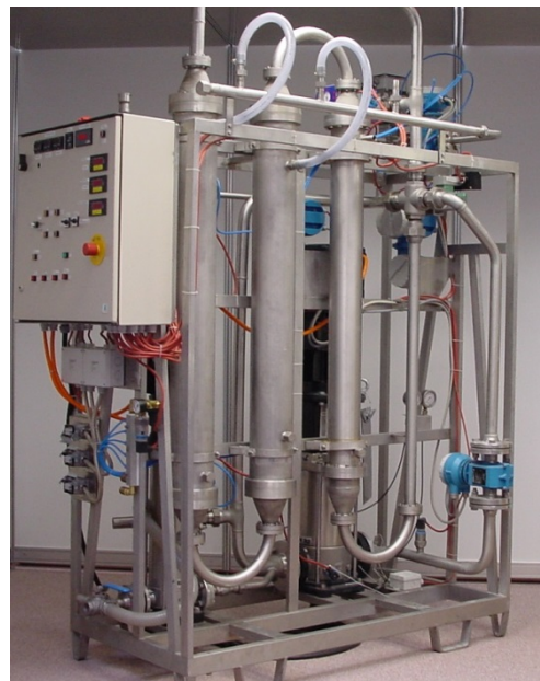
Abbildung 4-3: EFA Anlage vor dem Umbau
