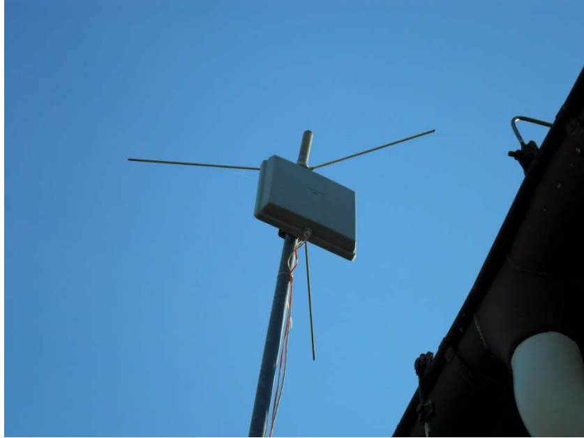
Abbildung 2.3.24: Foto von der Basisstation am Gebäude der Warte im Umspannwerk Niederwiesa
