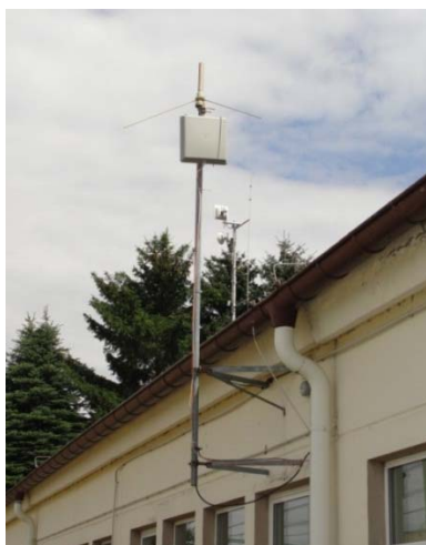
Abbildung 2.3.5: WLAN-Außenantenne und integrierter Empfangselektronik an Warte im Umspannwerk
