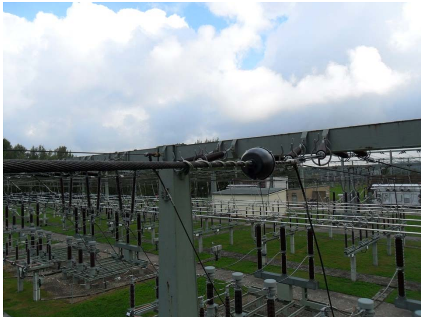
Abbildung 2.3.25: Foto vom Sensorknoten 1 im Umspannwerk Niederwiesa
