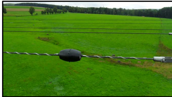
Abbildung 2.3.6: Sensorknoten nach der Montage auf einem 110 kV-Leiterseil beim Feldversuch in Niederwies
