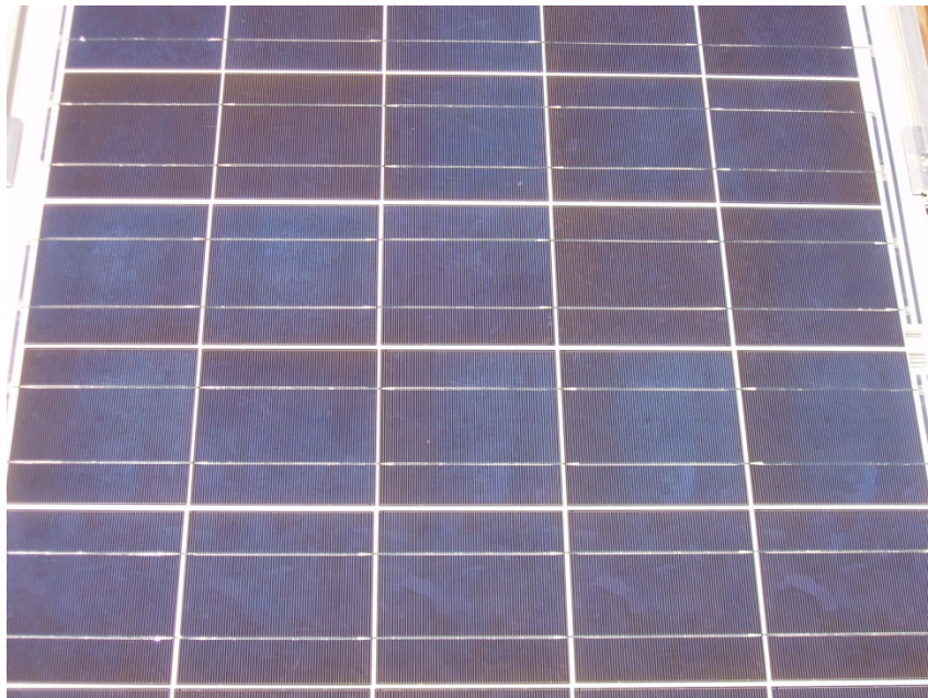
Abb. 6.10.3.2 Modul U9 mit Verfärbungen des Einkapselungsmaterials
