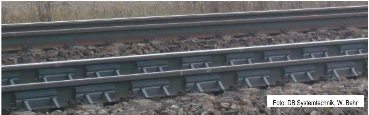
Abb. 2.23b: Ansicht der im Testabschnitt eingebauten Schienendämpfer der Fa. Vossloh
