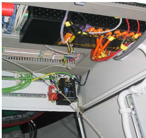
Abbildung 7-46: Installiertes CMS im Schaltschrank der M5000_2
