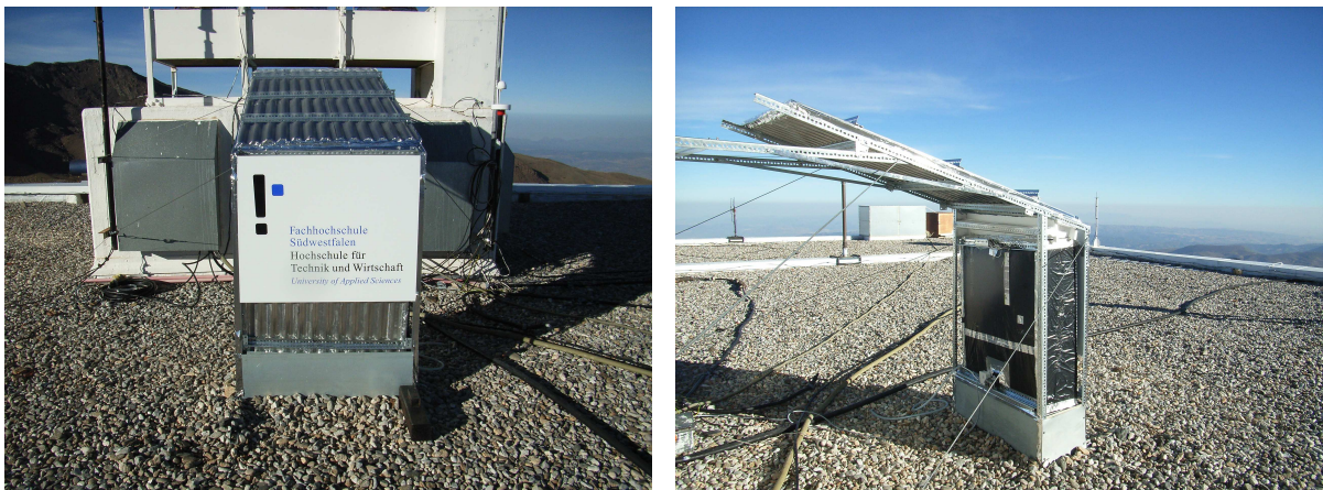
Abbildung 3: Wassersammler auf dem Dach des Observatoriums des Instituto de Radio Astronomia Milimétrica (IRAM) in Granada; links: Frontansicht, rechts: Seitenansicht
