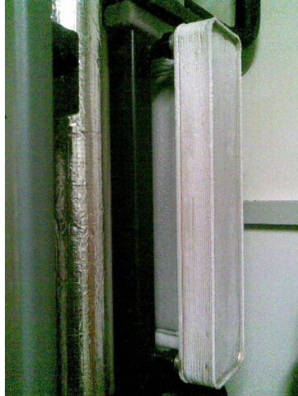
Abbildung 35: Vereisung des Wärmetauschers zwischen Solaranlage und Schichtspeicher
