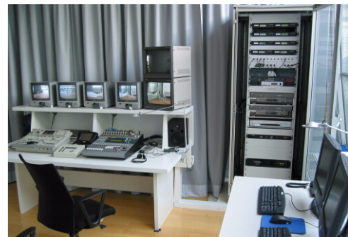
Regieraum: Bild- und Tonmischung, Kamera- und Medienraum-Steuerung, Signalverteilung; im Vordergrund rechts: Encoding-PCs
