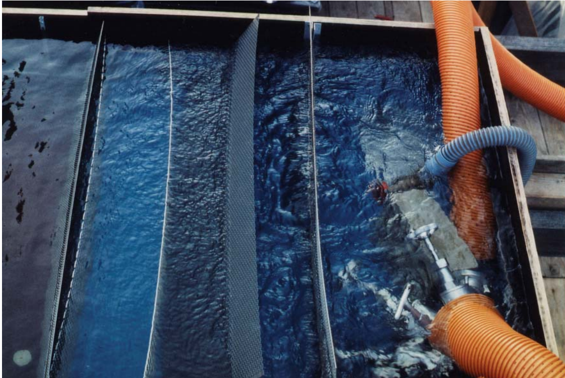
Abbildung 31: Tosbeckenkammer mit Schott und Lochblechen
