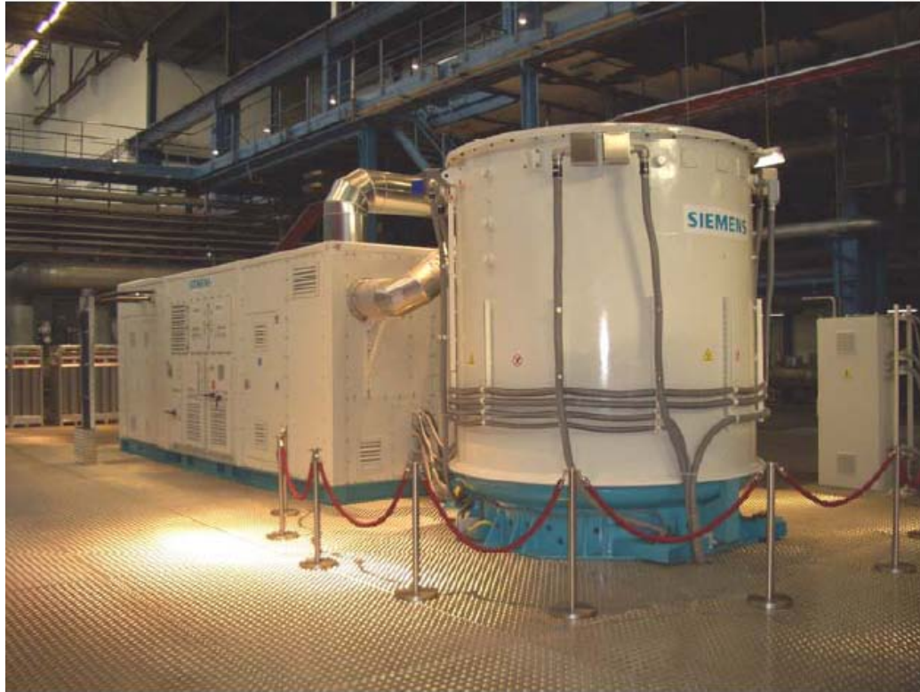
Abbildung 6-2: SOFC-BZ-Stromerzeugungsanlage [Enercity Hannover]
