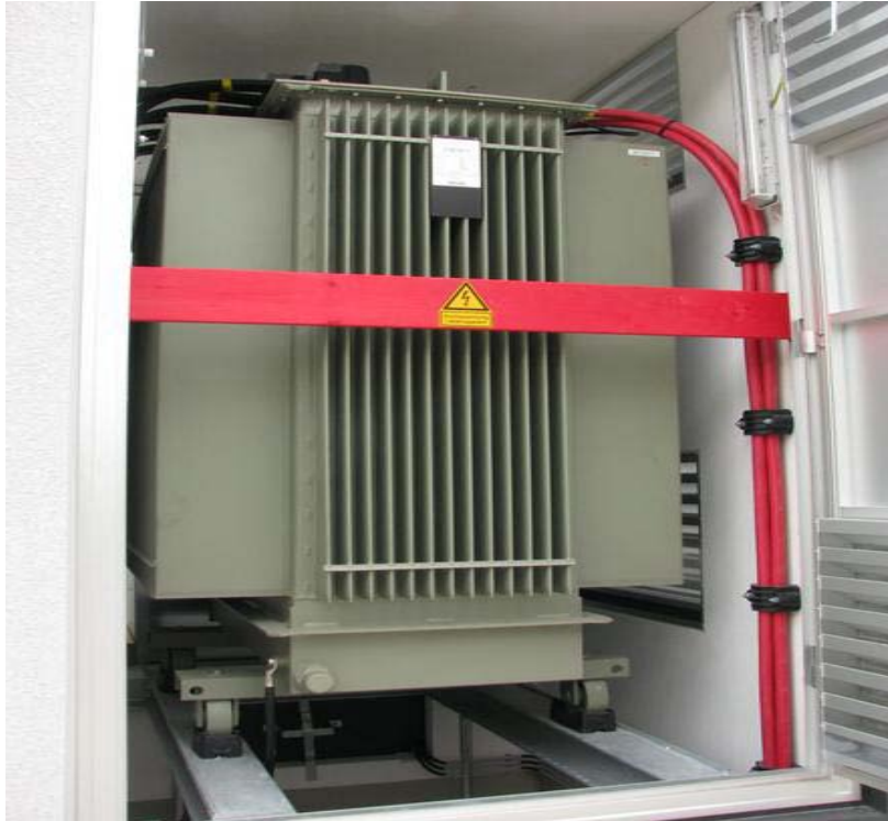
Abbildung 6-30: 1,25 MVA Netztransformator [PEGE]
